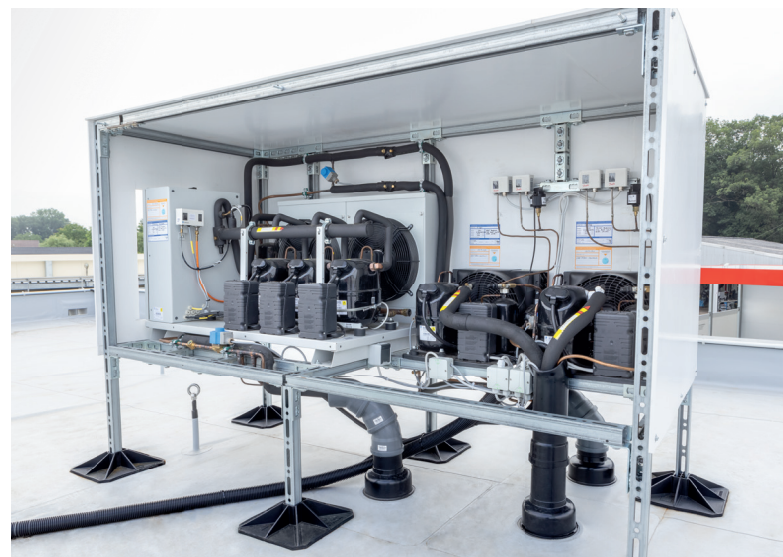
R-1234yf-Verbundanlage und zwei TK-Einzelanlagen mit R-454C.
