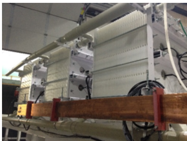
フロー電池エネルギー貯蔵ユニット
